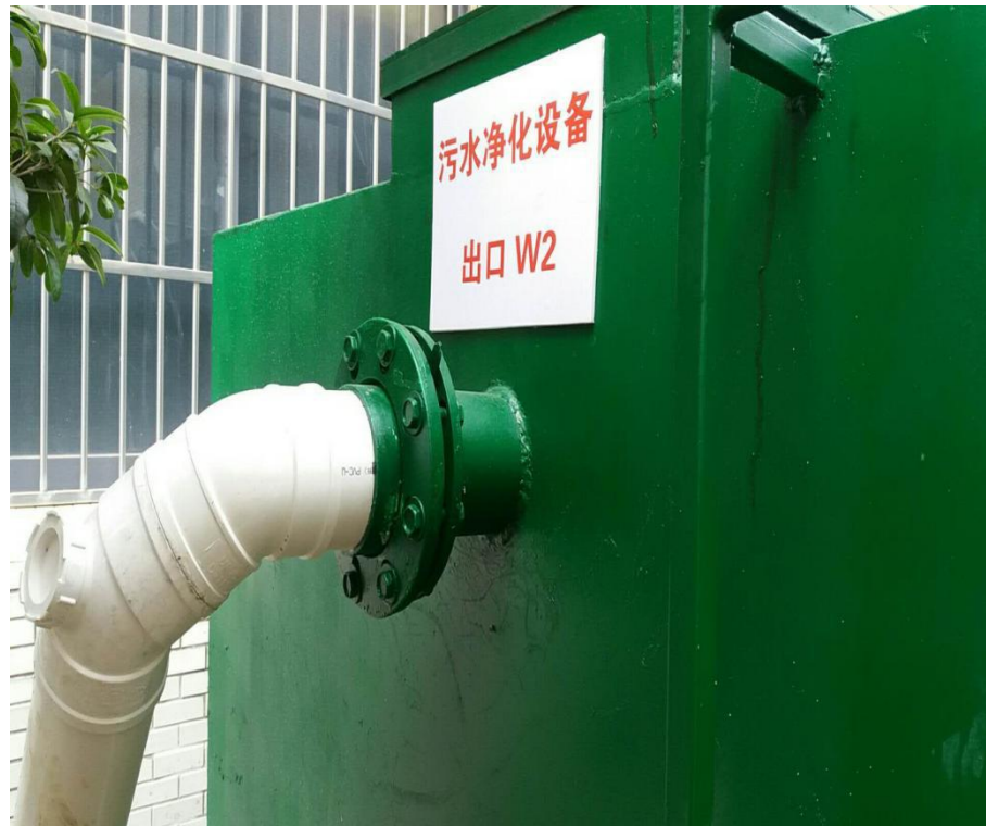
废水处理设施出口
