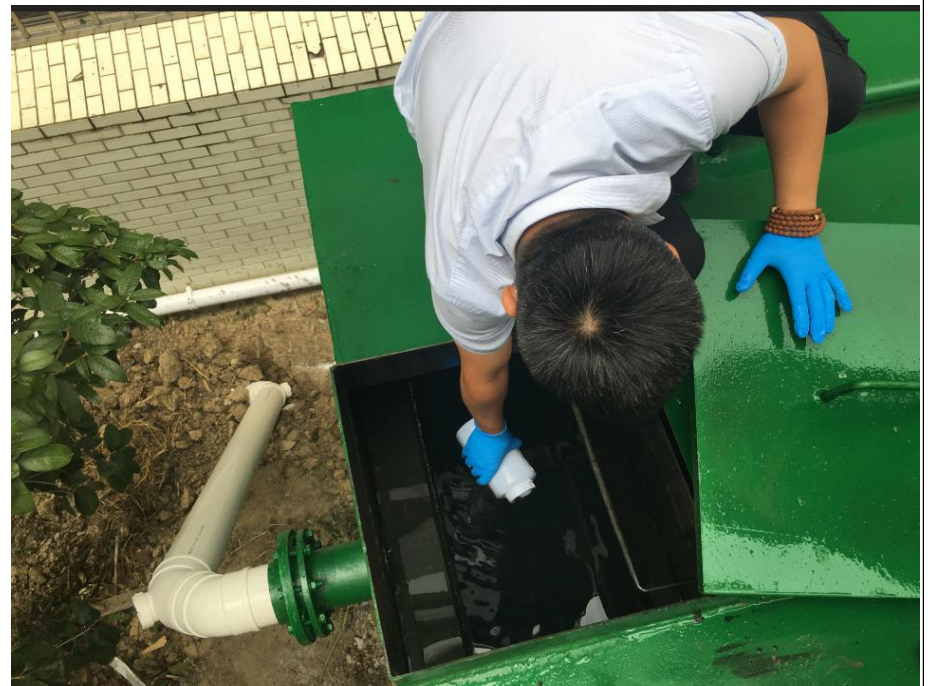
废水处理设施出口
