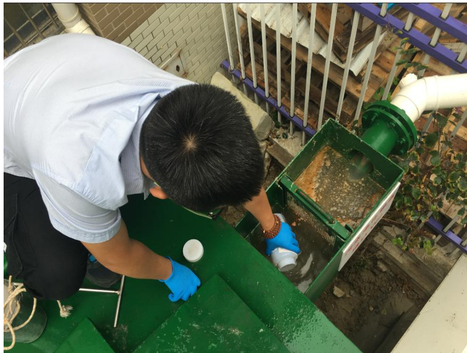
废水处理设施进口
