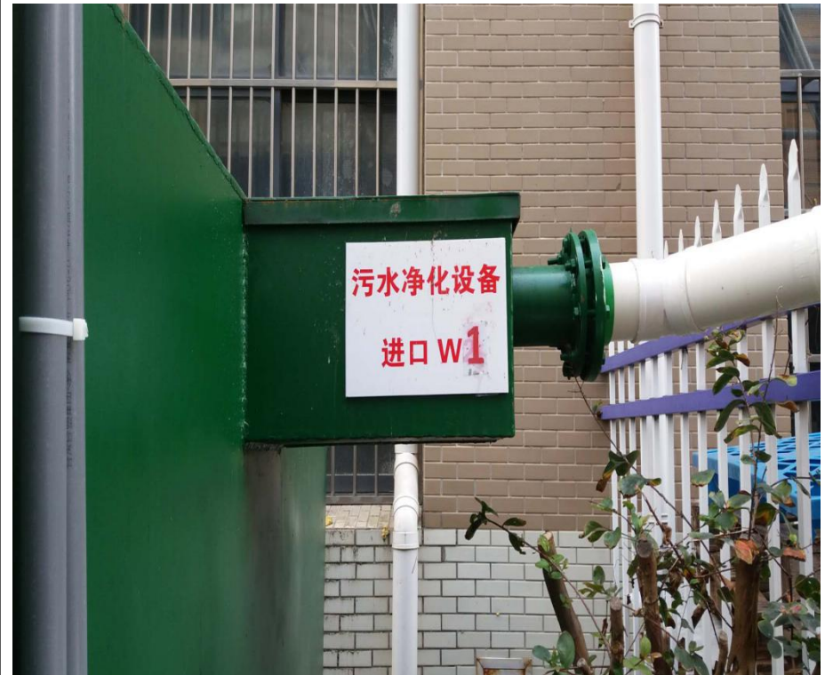
废水处理设施进口
