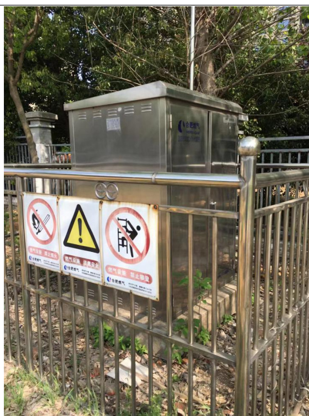
燃气调压柜隔间
