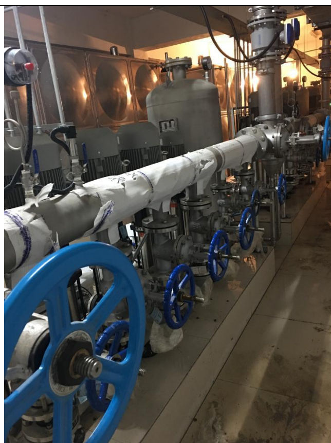
生活水泵房设备房
