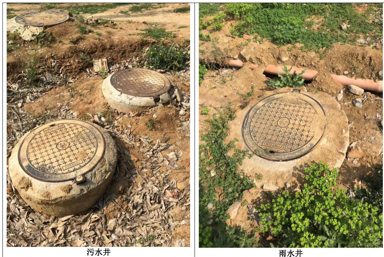
图 4.2-1 现场雨污水排水井图
