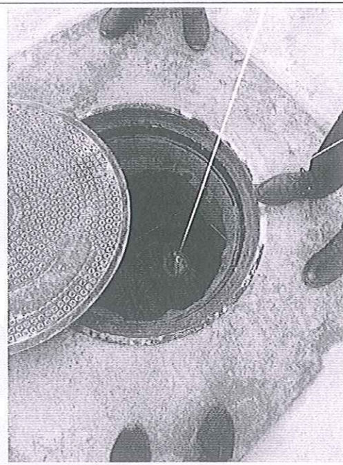
王河北污水排放口
