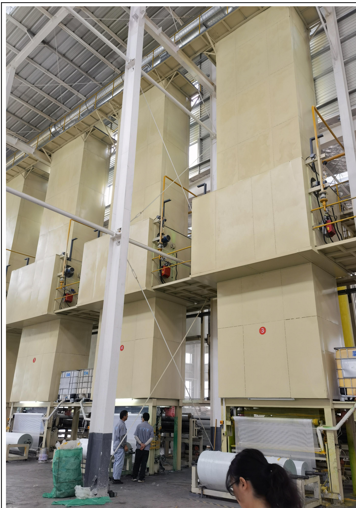
图 3-1 项目涂覆烘干一体化设施
