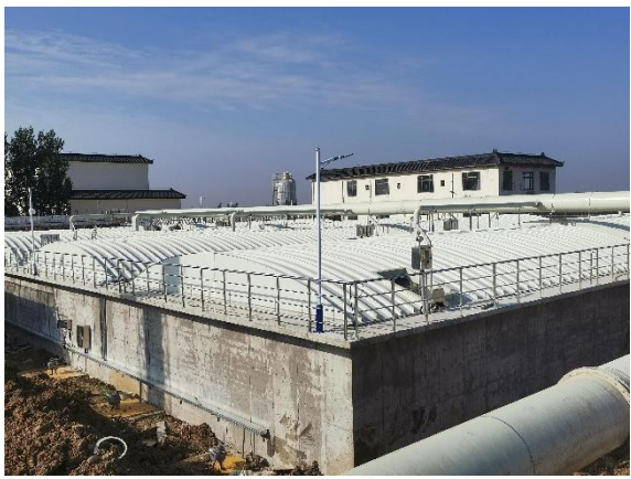
图 3-2 水解酸化池加盖密闭收集措施
