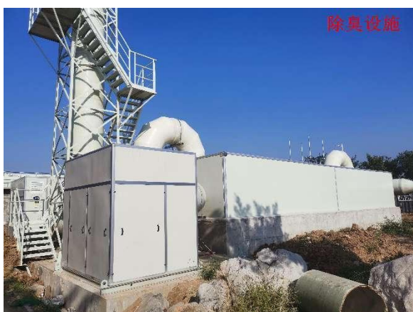
生物滤池除臭装置
