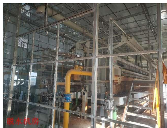
脱水机房玻璃房密闭收集
