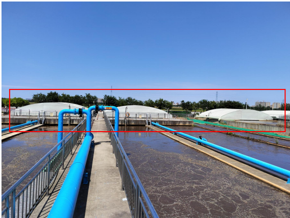
厌氧池加盖密闭收集措施
