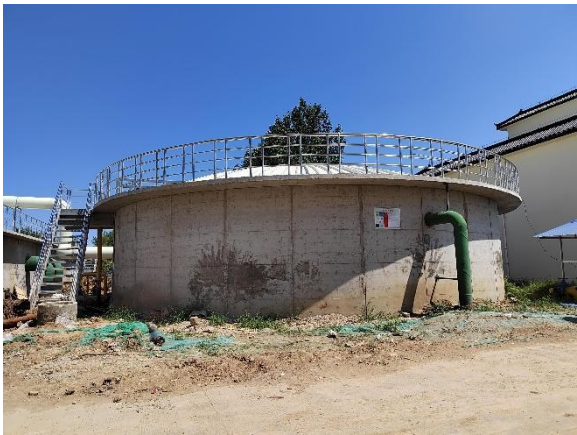
污泥浓缩池加盖密闭收集措施
