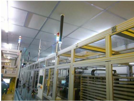
车间内部 切割设备
