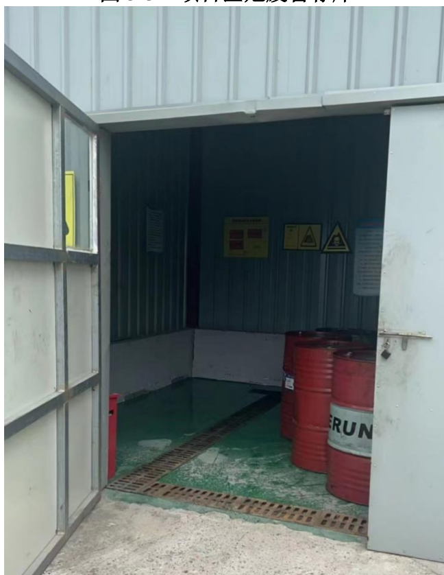
图 3-6 项目区危废暂存库（内部防渗、导流沟）
