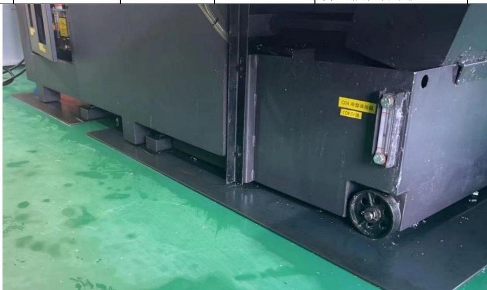
图 3-4 设备减震降噪措施
