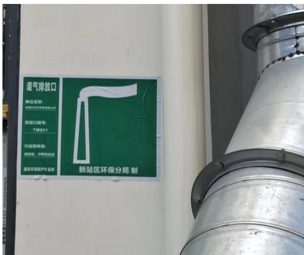
废气排放口环保标志牌
