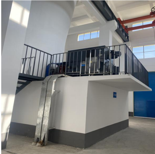
通风机房内部设备
