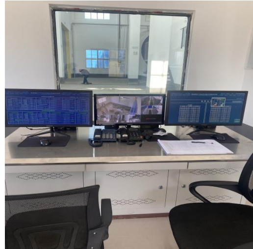
通风机房监控系统
