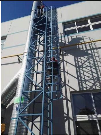
废气室外采样平台
