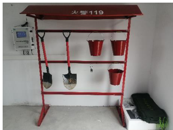
应急消防设施
