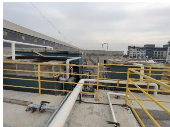
除氟反应池、气浮池
