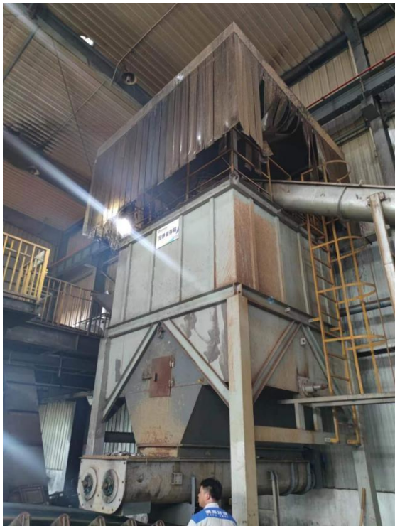
泥饼料仓上方设置软帘，顶部设置集气管道
