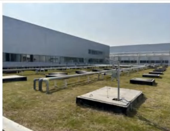
A 区已建污水处理站 (依托)
