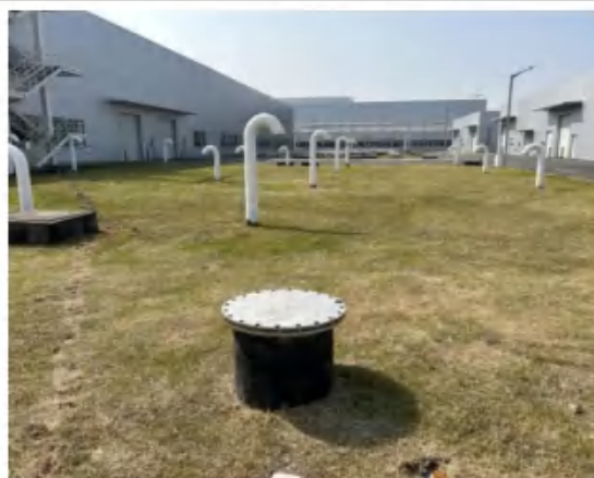
A 区已建事故池 (依托)
