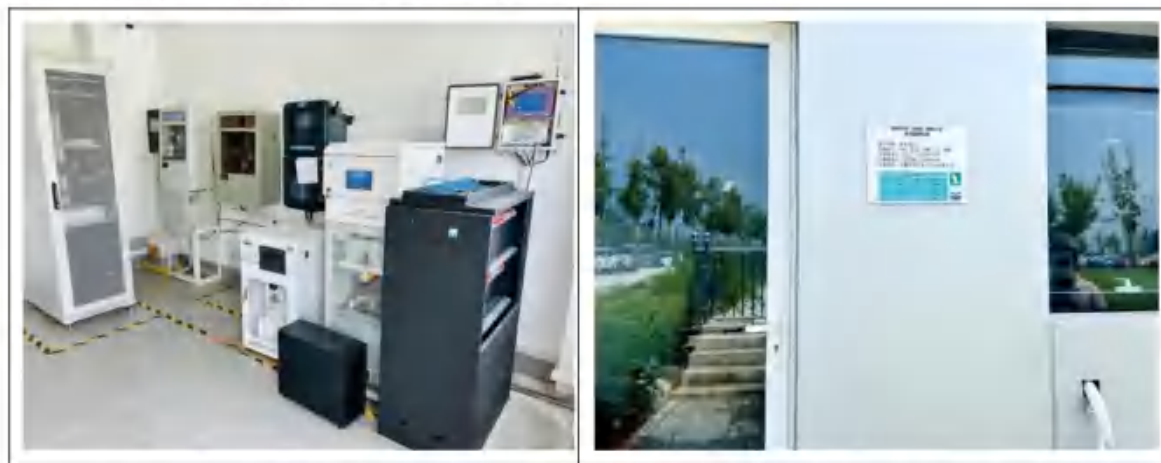
图 3-2 依托蔚来汽车科技（安徽）有限公司废水在线监测设备照片
