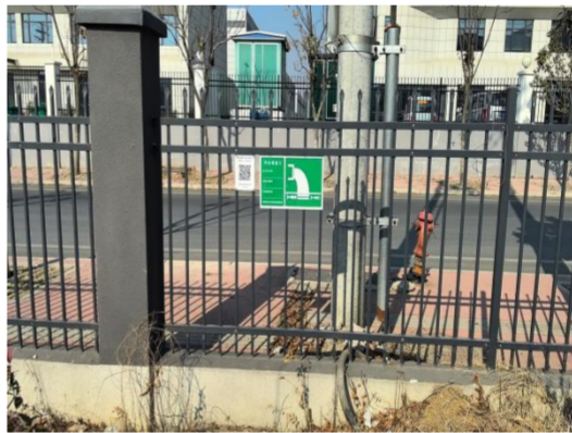
废水总排口及标识牌
