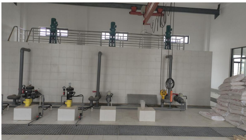
图 2-7 凤阳宁国现代产业园净水厂现状加氯加药间
