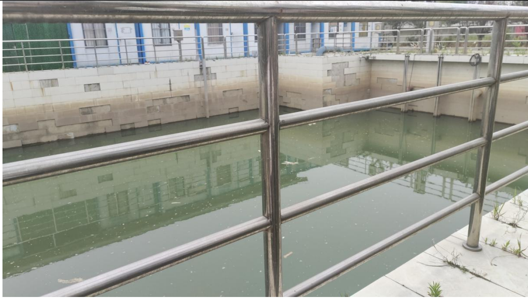
图 2-11 经开区净水厂现状清水池
