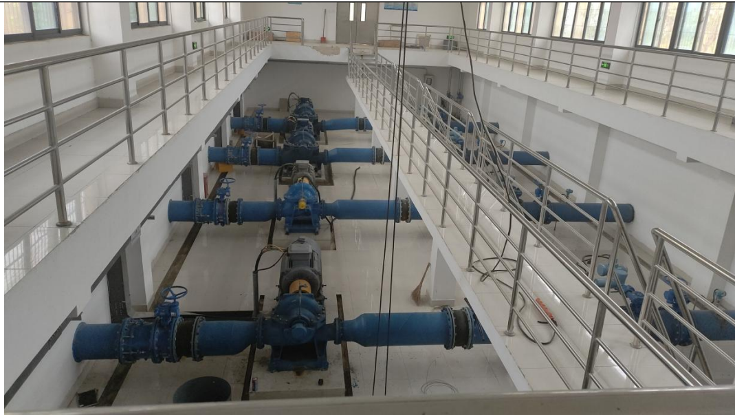
图 2-15 经开区净水厂现状送水泵房
