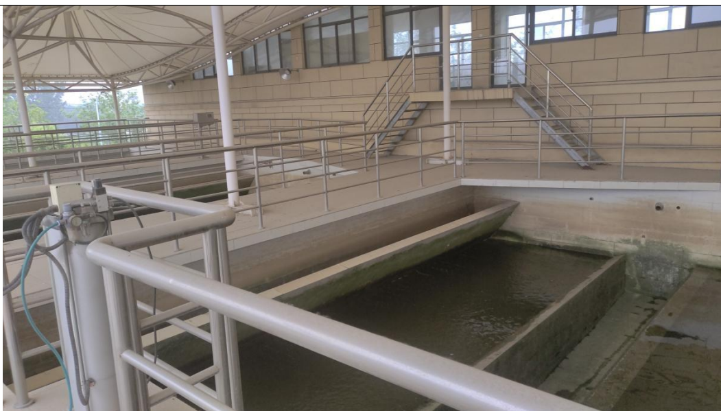
图 2-10 经开区净水厂现状 V 型滤池
